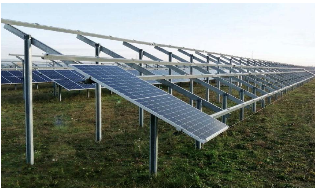
Slika 12. Izgled tipske čelične konstrukcije za montažu fotonaponskih modula
